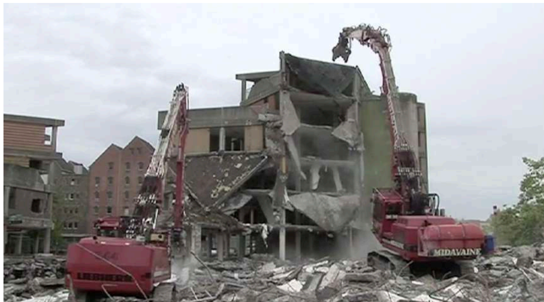
Une culture de la démolition qui s'élargit : les étoiles de Grande-Synthe de Renaudie, dans la ZAC, réduites en gravats © TOUCHARD Frédéric - 2009
