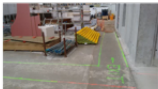
Marquage des zones de circulation, stockage et déchet selon le modèle LEAN. (photo : CSTC)
